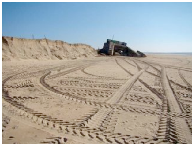
Fig. 34 – Basculement des blockhaus sur la plage à la suite du passage de la tempête Xynthia .
