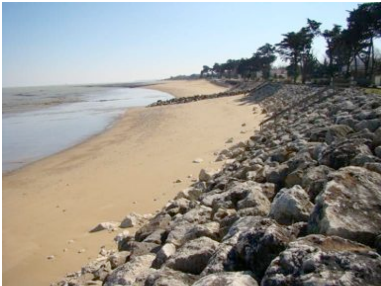
Fig. 7 – Plage de Planginot, la Brée-les-Bains La plage s'est maintenue. Le cordon d'enrochement n'a pas été déstabilisé.
