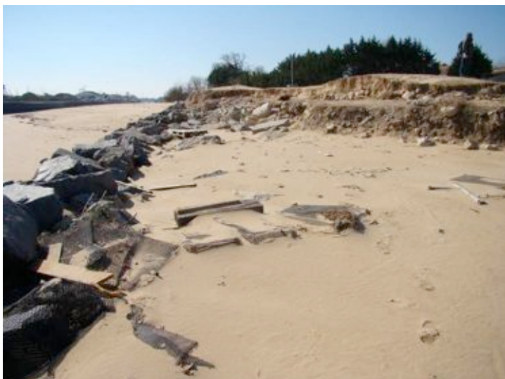
Fig. 10 – Érosion des berges du chenal de la Perrotine dans sa partie aval : on voit bien sur cette photographie l'attaque des berges à l'arrière de la digue de protection, la projection de matériel ostréicole arraché sur l'estran, ainsi que, sur la gauche, le dépôt d'importants volumes de sable à l'intérieur du chenal.
