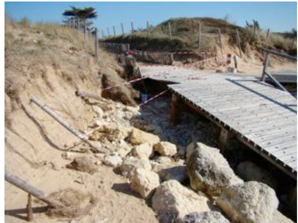
Fig. 28 – Rampe d'accès de la plage de la Rémigeasse : l'érosion de la dune de part et d'autre de cet équipement a provoqué sa déstabilisation.
