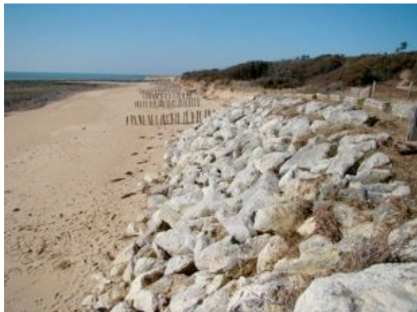
Fig. 30 – Vue vers le nord, secteur de l'Écuissière. Le cordon d'enrochement a fixé le trait de côte au droit de l'aire de stationnement, mais le recul se poursuit de part et d'autre de cet ouvrage.
